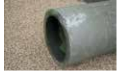
Rohr mit beschädigter Oberfläche
