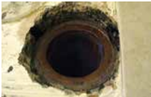
Bündig abgeschnittene Rohre
