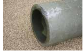
Rohre mit beschädigter Oberfläche
